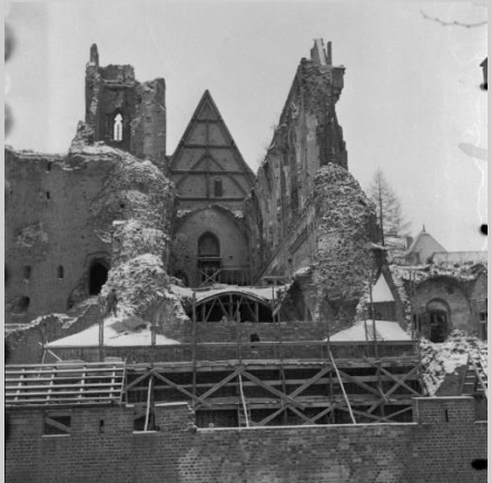
Malbork. Widok od wschodu na odbudowę prezbiterium kościoła zamkowego. Fot. zima 1959 r.
