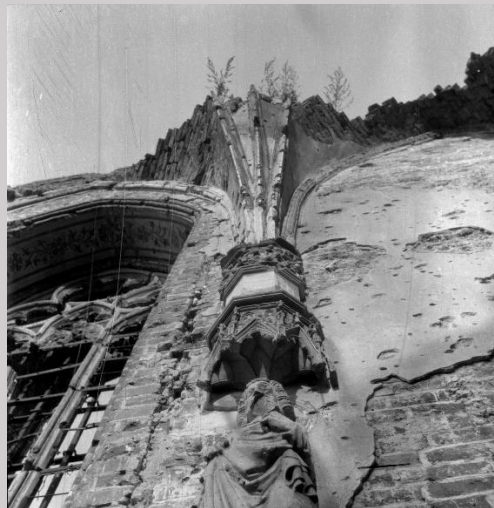
Malbork. Widok na ruinę wnętrza kościoła zamkowego. Fot. 1958 r.
