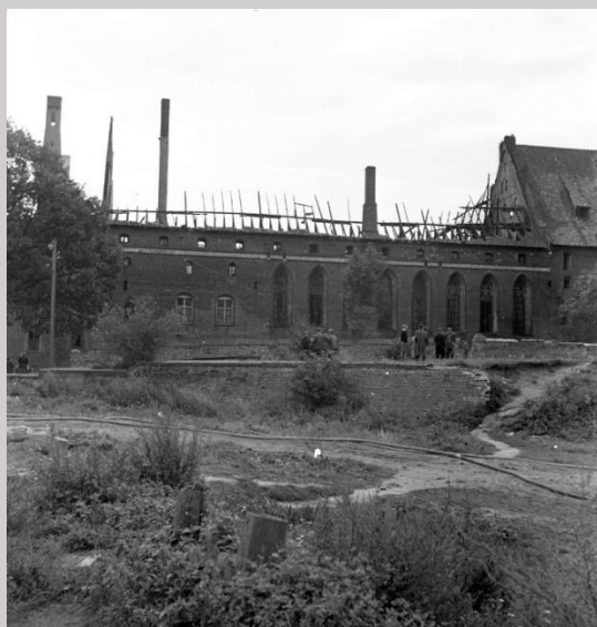
Malbork. Widok na zachodnie skrzydło Zamku Średniego po pożarze dachów 7/8 września w 1959 r.
